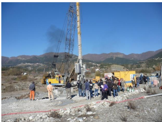
ΦΩΤ. 1. Κατασκευή αδιαπέρατου διαφράγματος κάτω από τον πυρήνα του φράγματος Μετσοβίτικου μέχρι το βραχώδες υπόβαθρο (φλύσσης) με ειδικό μηχάνημα (τύπου KELLY), που φέρει ειδικό σκαπτικό μηχανισμό (μπένα).
