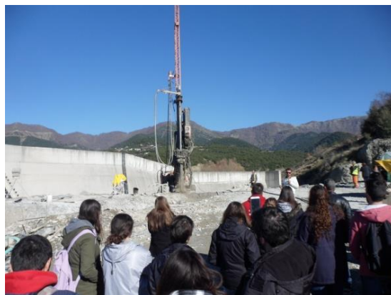
ΦΩΤ. 2. Κατασκευή εδαφοπασσάλου με Jet grouting με ειδικό μηχάνημα διάτρησης και διοχέτευσης ενέματος με πίεση 30 - 50 atm. εντός των χαλαρών υλικών μέχρι και ένα μέτρο μέσα στο βράχο (φλύσσης).
